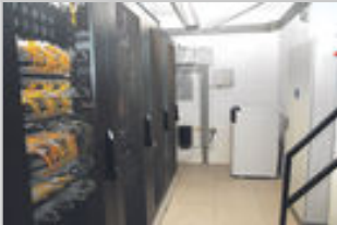
Rechenzentrum 1 (Foto: Landkreis Helmstedt)
